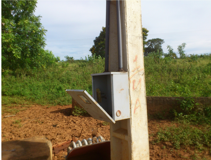
FIGURA 11 TERRENO DO CAMPUS DE JANAÚBA (MG) FORNECIMENTO DE ELETRICIDADE: MEDIDOR E CAIXA DO TRANSFORMADOR: VANDALISMO, EM 07/02/2013 (Fonte: PAIVA, J.E.M.)
