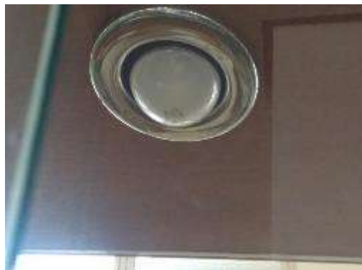
Figura 7.4 - Lâmpada Mista Existente na Instalação
