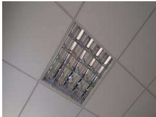
Figura 7.3 - Lâmpada Fluorescente Tubular Existente na Instalação
