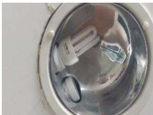
Figura 7.7 - Lâmpada Fluorescente Compacta Existente na Instalação
