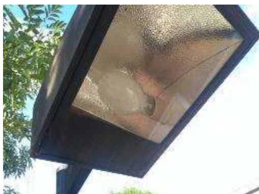
Figura 7.6 - Lâmpada Vapor de Sódio Existente na Instalação
