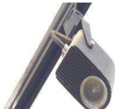
Figura 7.9 - Lâmpada Halógena Existente na Instalação
