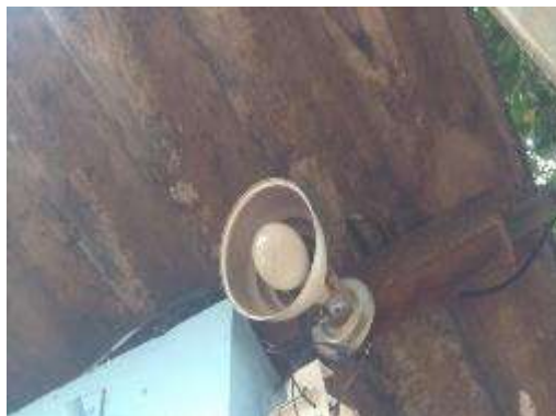
Figura 7.8 - Lâmpada Vapor Metálico Existente na Instalação
